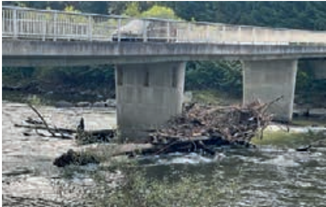
Verklauung bei der Murbrücke zur Lainsach
