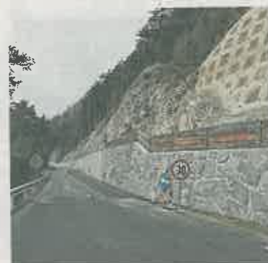
Die neue Hangmauer und ein Steinschlagnetz sorgen für eine sichere Zufahrt. Foto: Wiederin
