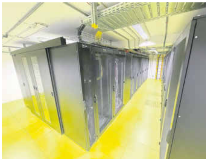
Einer der beiden Räume im KGRZ, in dem nunmehr die Server der Stadtverwaltung Idar-Oberstein untergebracht sind.
